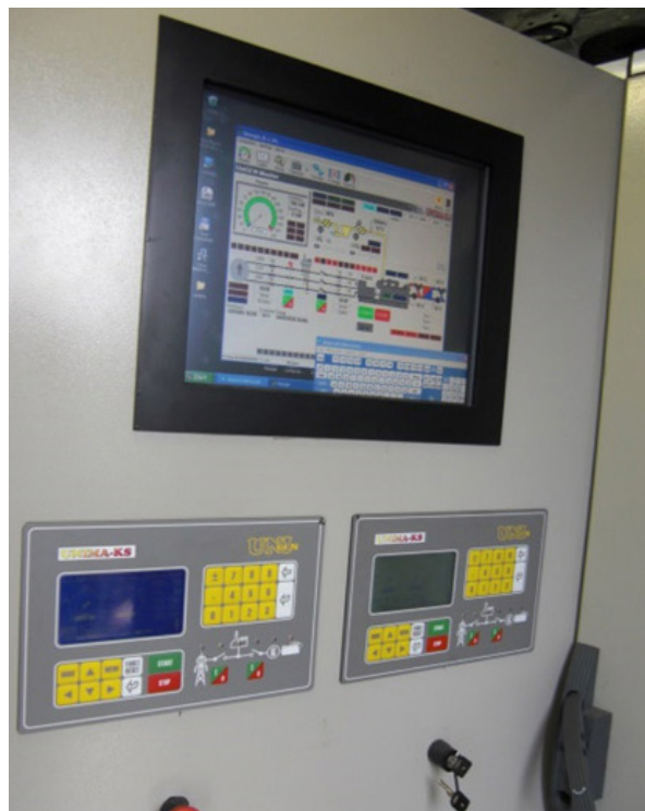
Control panel in Gyál.
